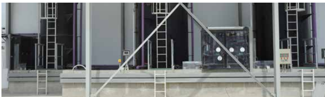
Station Eaucéan - Système de désodorisation de l'air
