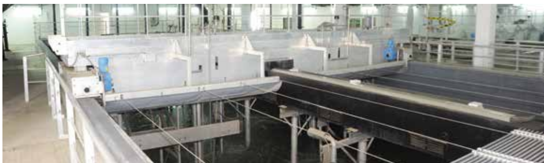
Station Eaucéan - Dessablage Déshuilage
