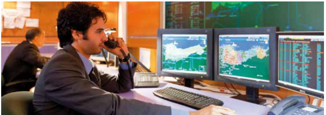
Centre de Conduite Centralisée.
