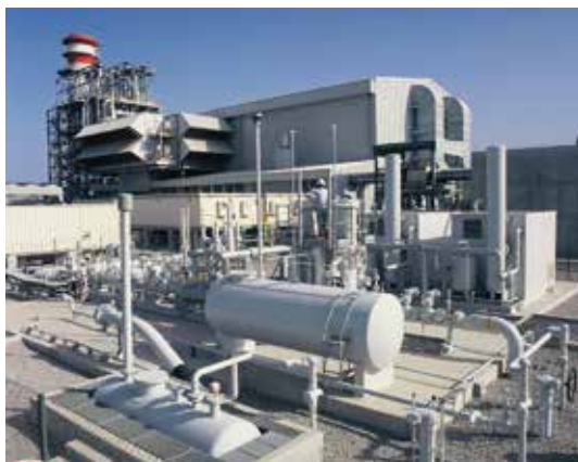
La centrale thermique à cycle combiné tahaddart
