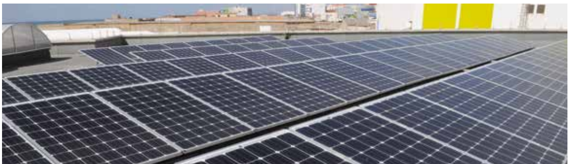
Station Eaucéan - Panneaux solaires
