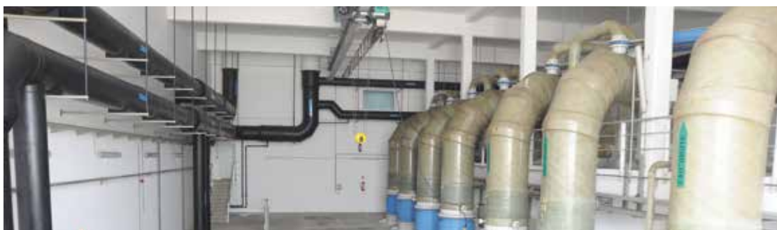
Station Eaucéan - Pompage profond
