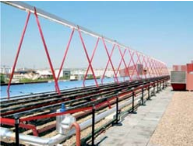
Prototype de climatisation solaire sur la toiture de l'Université de Seville (Mirrox)
