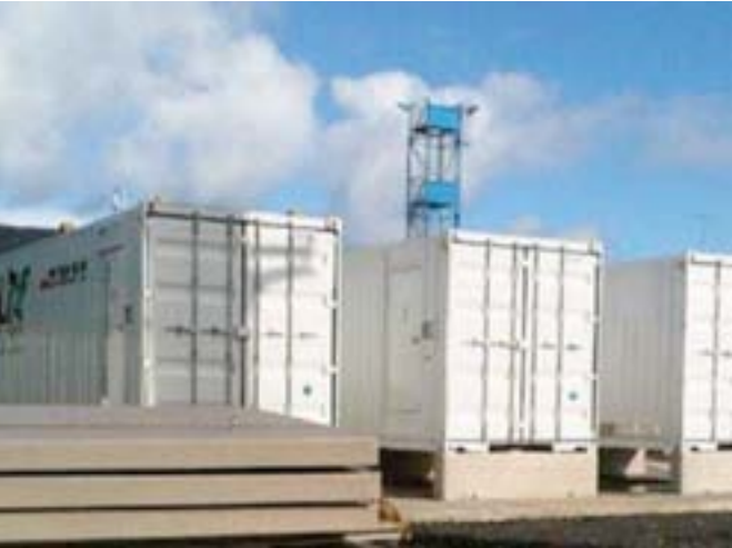
Figure 4 : Containers de batteries lithium-ion installés sur le parc Okney en Ecosse permettant un stockage électrochimique efficace d'une puissance de 2 MW (Source: energystorageexchange.org)
